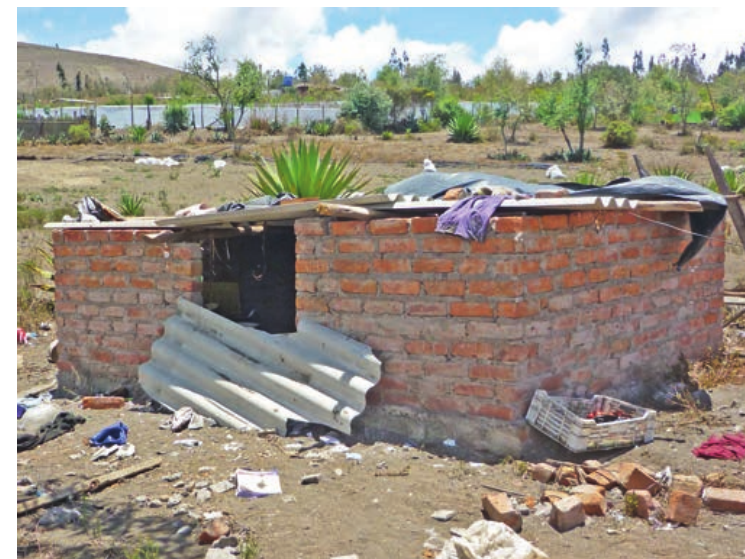
Figura.5.1 Precariedad en vivienda 3000 m.s.n.m – Chingazo Provincia de Chimborazo
